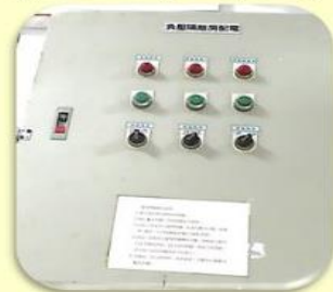
負壓隔離房配電控制
